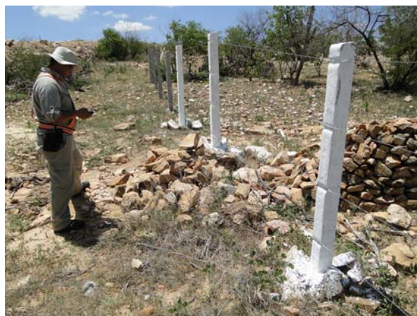
Legenda Foto 0893 (SW) Documentação de muro de pedra destruído parcialmente para implantação da rodovia.
